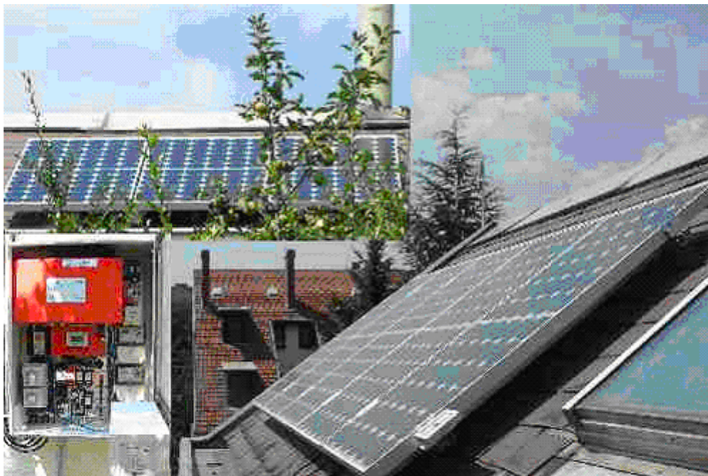
8.ábra A Solart-System Kft egyik 1 fázisú 230 V –os kváziautonóm napelemes áramforrása
