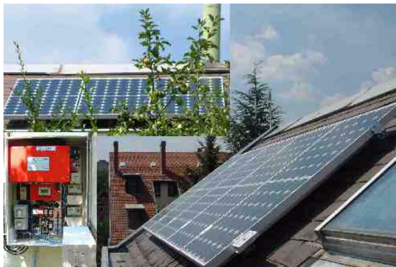
3. ábra. A Solart-System Kft. egyik kváziautonóm napelemes áramforrása.
